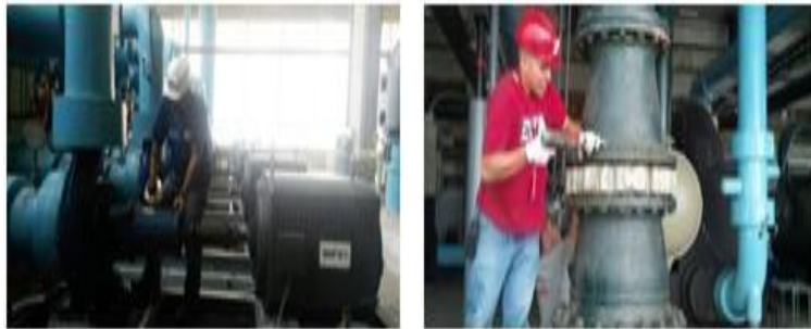
Ilustración 113. Mantenimiento mensual de las estaciones de bombas de agua potable.
