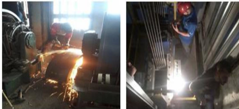
Ilustración 114. Mantenimiento preventivo y correctivo menor de ascensores.
