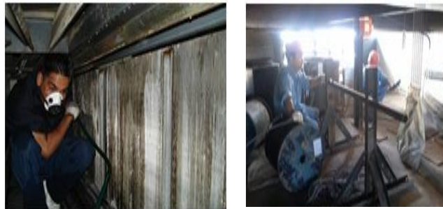
Ilustración 110. Mantenimiento preventivo y correctivo menor de los ascensores residenciales.
